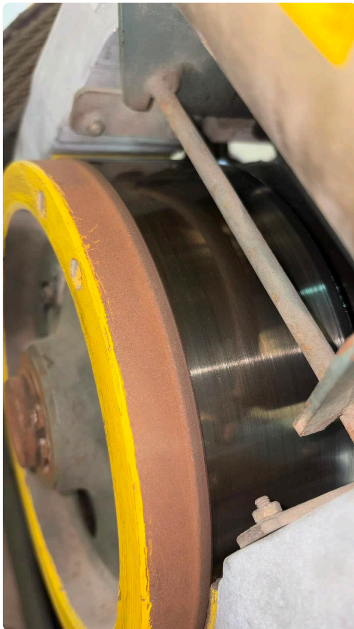
ÓLEO SOBRE O TAMBOR DE FREIO E LONAS, NÍVEL MÉDIO DE RISCO.
